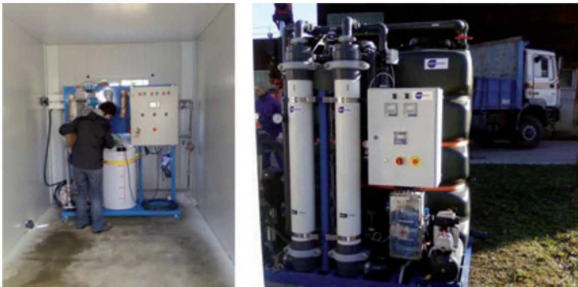
Figura 16. Detalle de la unidad de ósmosis inversa en el interior de la caseta instalada en la EDAR y detalle de la unidad de ultrafiltración antes de ser colocada en el interior de la caseta.
