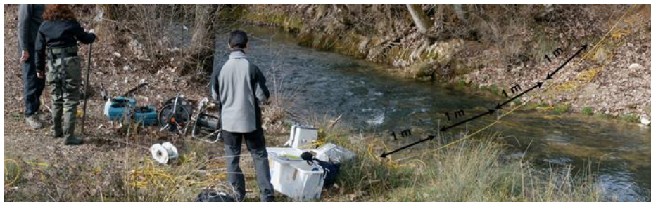
Figura 2. 14. Disposición de los electrodos a lo largo del perfil transversal al cauce del río para el estudio de resistividad eléctrica mediante la técnica ERT. Foto correspondiente al punto T6: Romancos (Guadalajara).
