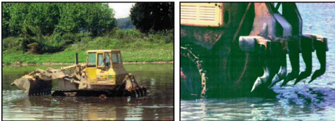
Figura 21. Dispositivos de escarificado del lecho del río Llobregat para el aumento de la recarga al acuífero. (Armenter et al, 2009).
