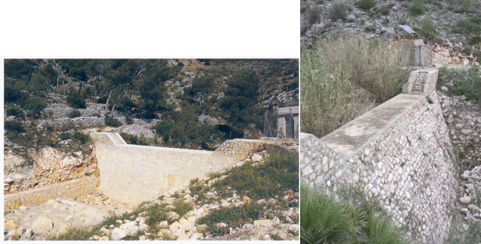
Figura 38. El dique de vaso permeable construido en el Barranco de Fontilles tiene como objetivo retener parte de la escorrentía superficial que circula por el cauce e infiltrarla en el acuífero (IGME, 2000).
