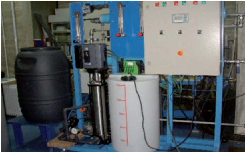
Planta piloto de Ósmosis Inversa.
