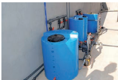
Detalle del sistema de riego.
