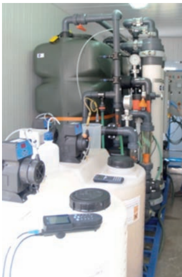
Planta piloto de Ultrafiltración.
