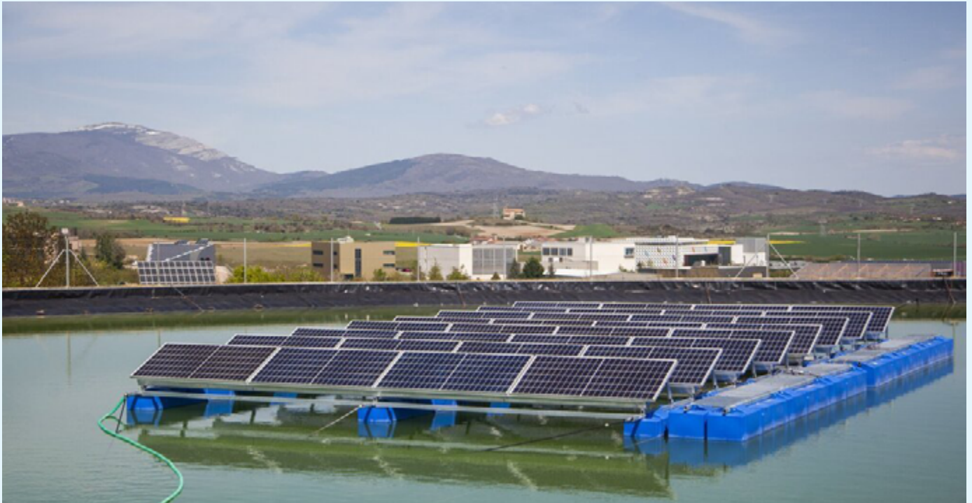
Primera instalación flotante de energía fotovoltaica en Euskadi
