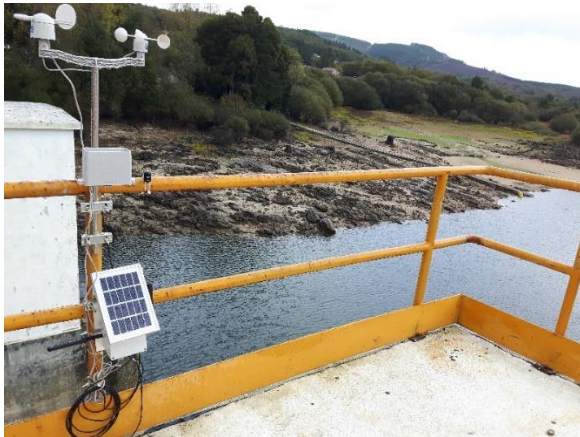
Figura 19. Instalación inicial de la estación meteorológica WS-3000 en la zona de la presa.
