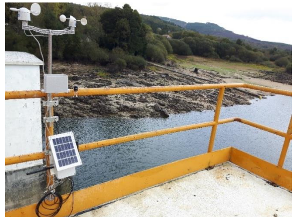
Figura 19. Instalación inicial de la estación meteorológica WS-3000 en la zona de la presa
