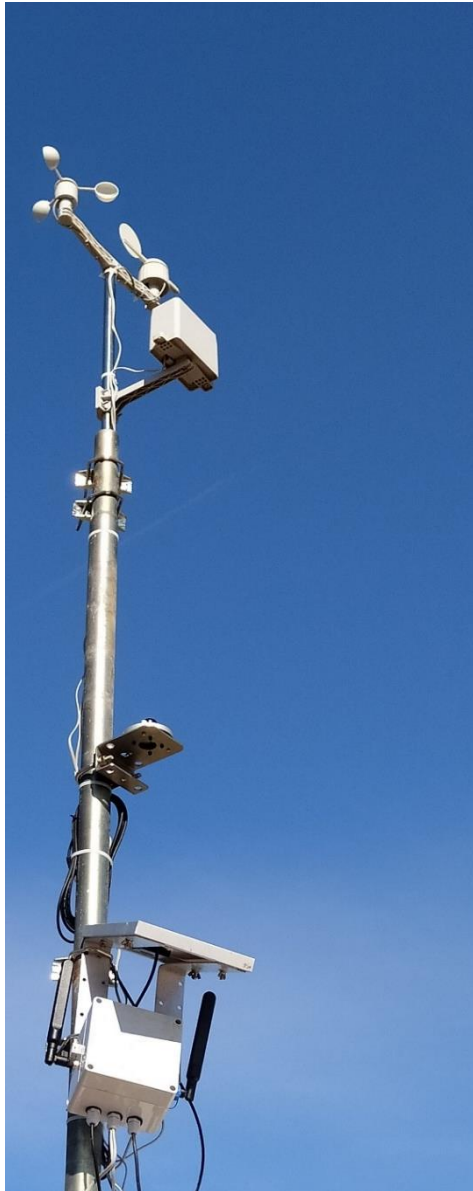
Figura 17. Instalación inicial de la estación meteorológica WS-3000 con su correspondiente nodo en la oficina de gestión técnica del parque de la Albufera de Valencia
