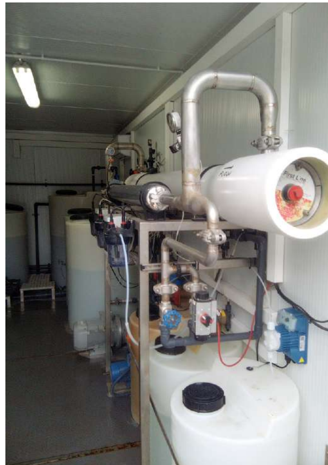
Figura 4.1_5 Sistema de nanofiltración (Fuente: Eurecat)
