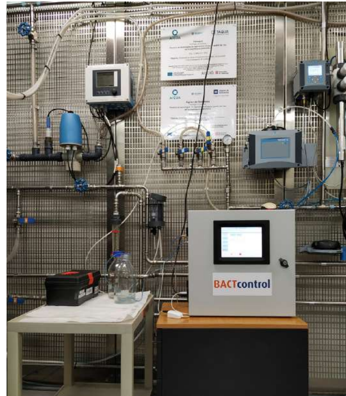
Figura 4.2_1 Analizador BACTcontrol instalado en la plataforma de sensores de Collblanc
