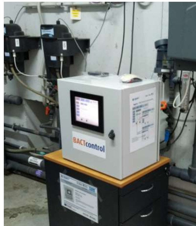
Figura 4.2_2 Analizador BACTcontrol instalado en la salida del MBR de la EDAR Gavà-Viladecans
